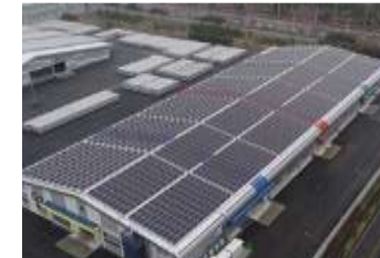
부산 조달청 비축기지 (0.7MW)
